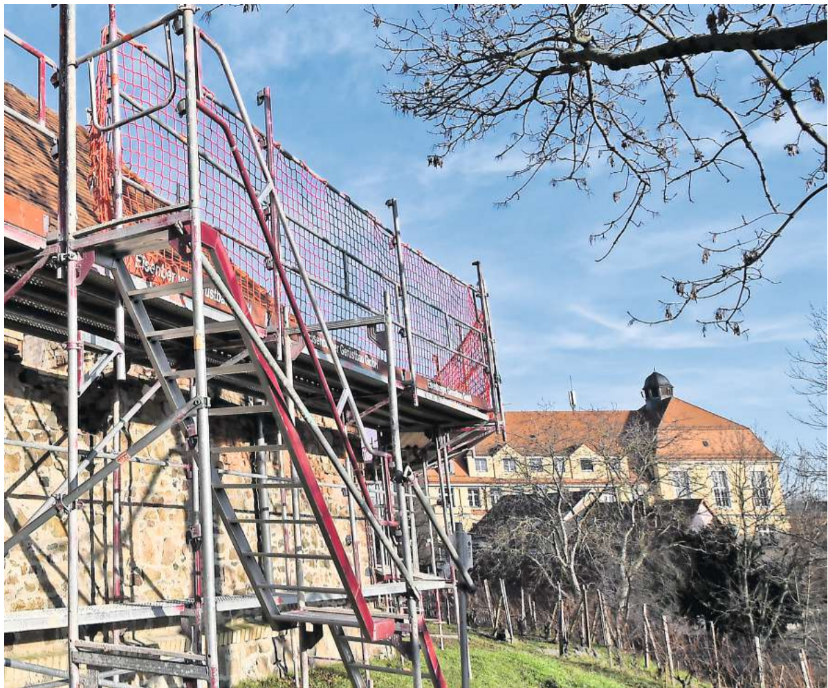
Auch außen ist das Rittergutsschloss Taucha eingerüstet. Rechts zieht sich der Weinberg Richtung Schlosstraße, im Hintergrund ist Tauchas Rathaus zu sehen. FOTO: OLAF BARTH
