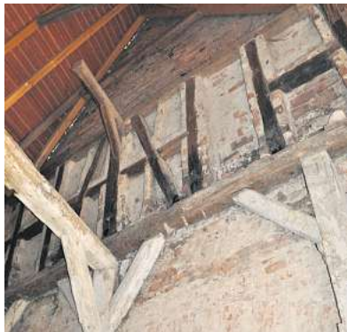
Das bei der Entkernung gefundene alte Fachwerk soll aufgearbeitet und der Nachwelt erhalten werden.
