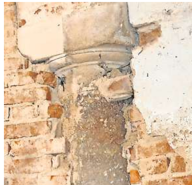
Die bei den Sanierungsarbeiten entdeckte alte Säule soll freigelegt und später beleuchtet werden.
